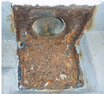
さびで傷んだルーフトドレン
