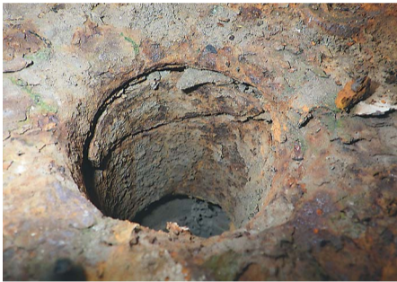
ドレン金物劣化による破断状況
